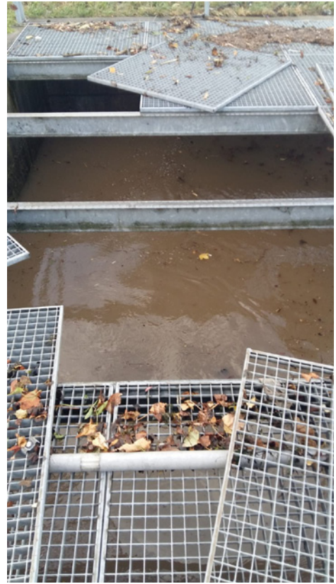
Dem Düker des Krebsbachs hat es den Deckel gelüpft: Das Wasser floss auf die Autobahn. (Bild: Niklaus Jung)
