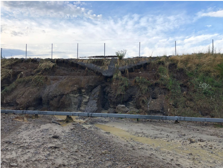
Statt unterirdisch floss der Krebsbach auf die Autobahn und liess einen Hang abrutschen. (Bild: kapo)
